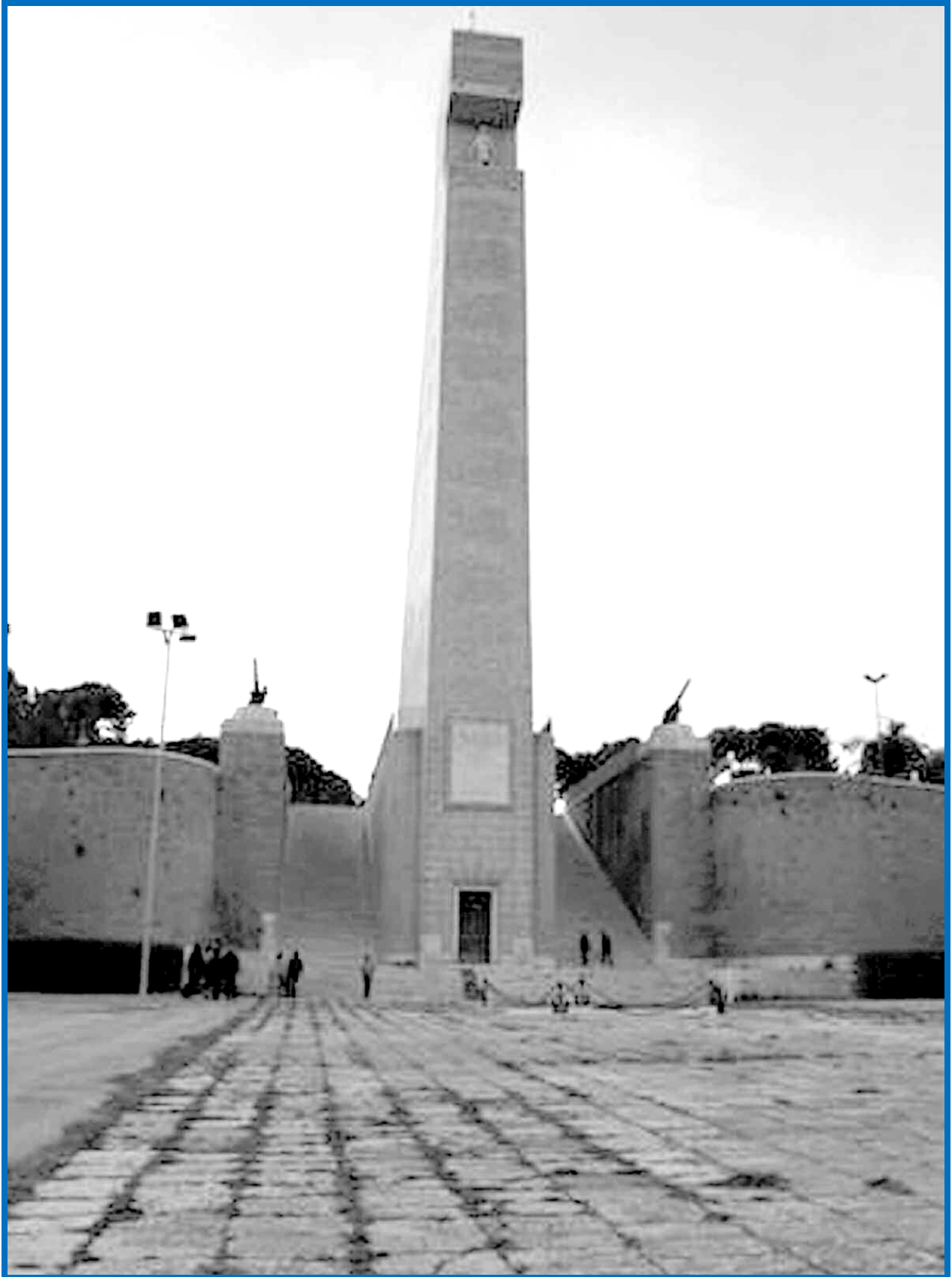
Sono visibili i ciuffi d'erba dovuti all'eccessiva umidità del sottosuolo
