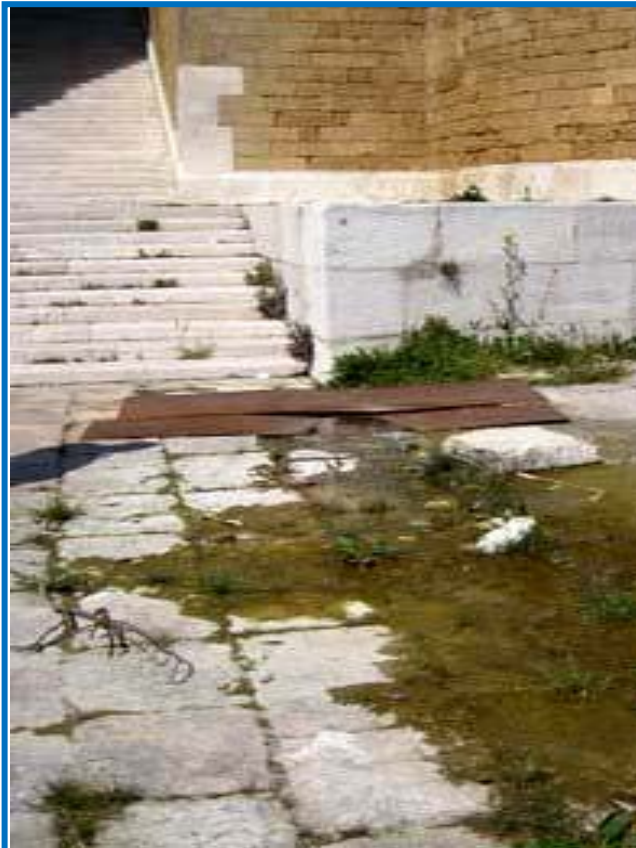
Tracimazione dell'acqua dalla camera sotterranea
