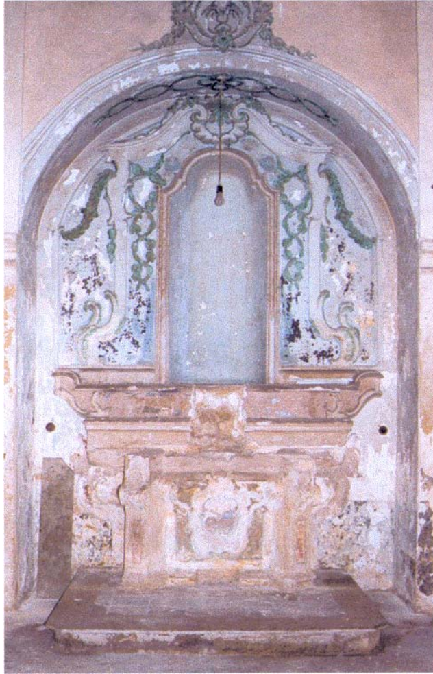
Foto n. 11 -Altare sul lato destro, mancante di alcune decorazioni
