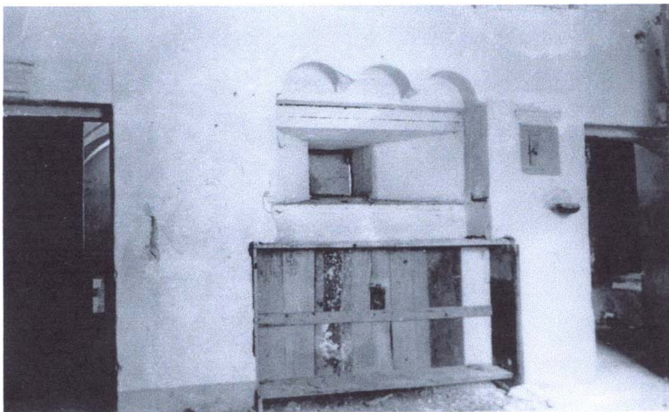
Foto n. 2 -La parete di separazione fra Altare Maggiore e sacrestia, prima dei lavori di restauro
